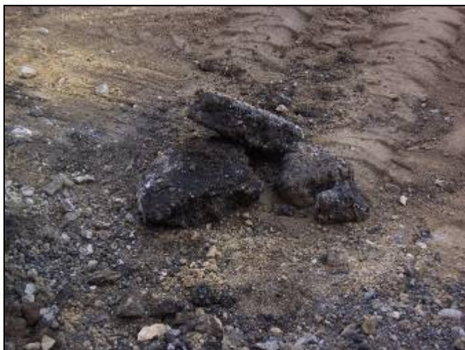
Figura 23 Il conglomerato bituminoso ha ottime capacità elastiche ma, a causa del deterioramento del bitume (che è un materiale organico), non conserva per tempi molto lunghi le sue qualità.
