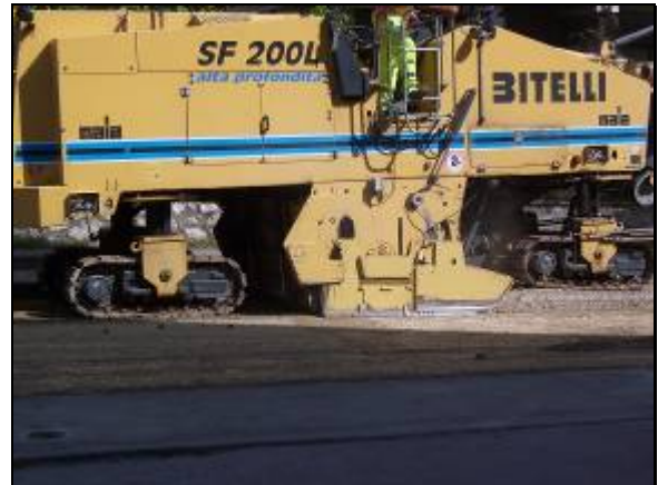
Figura 6 È possibile notare lo spessore asportato e i cingolati della macchina che consentono la migliore aderenza al suolo.
