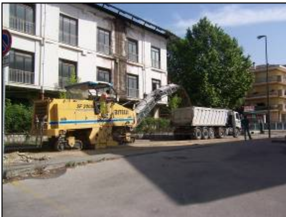
Figura 4 La fase di demolizione è mostrata in questa immagine nel suo complesso, la demolitrice convoglia il materiale al dumper.
