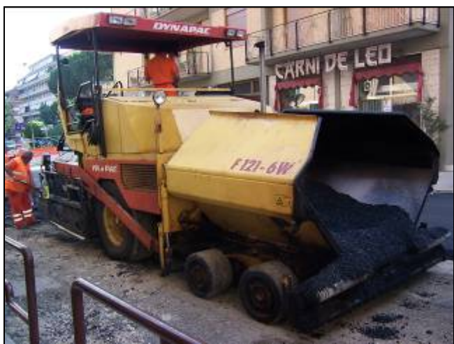
Figura 21 La vibrofinitrice in azione; notare come il conglomerato bituminoso viene comunque steso in maniera più accurata a mano nelle zone più difficili da raggiungere.
