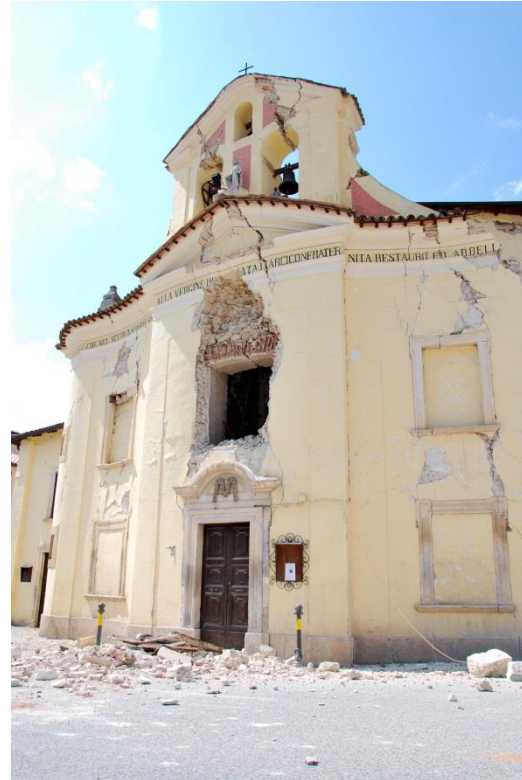
Danni importanti e parziale collasso della Chiesa dell'Immacolata Concezione a Paganica.
